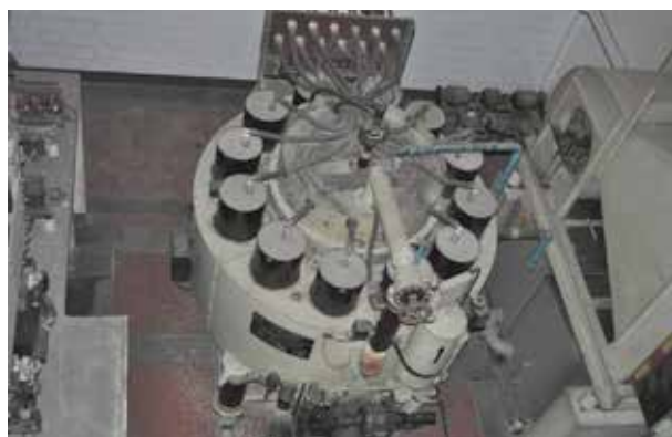
Slika 23: Živin usmjerivač izmjenične struje u istosmjernu na elektro podstanici Matulji. (foto Orbanić 2012.)
