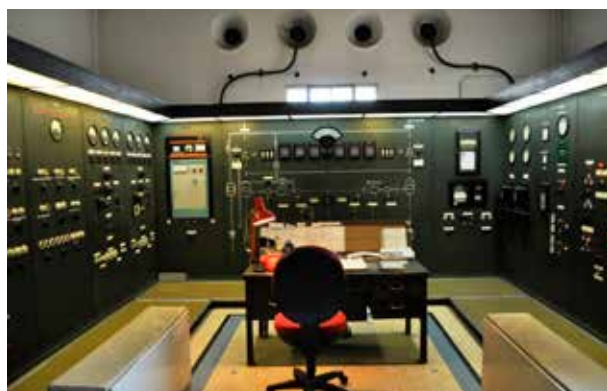
Slika 22: Komandni prostor elektro podstanice (foto Orbanić 2012.)
